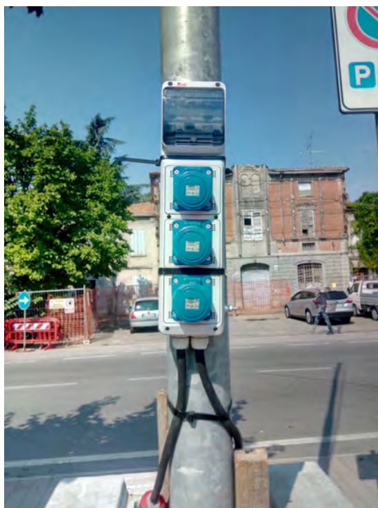
Power box a servizio delle varie sezioni elettriche
