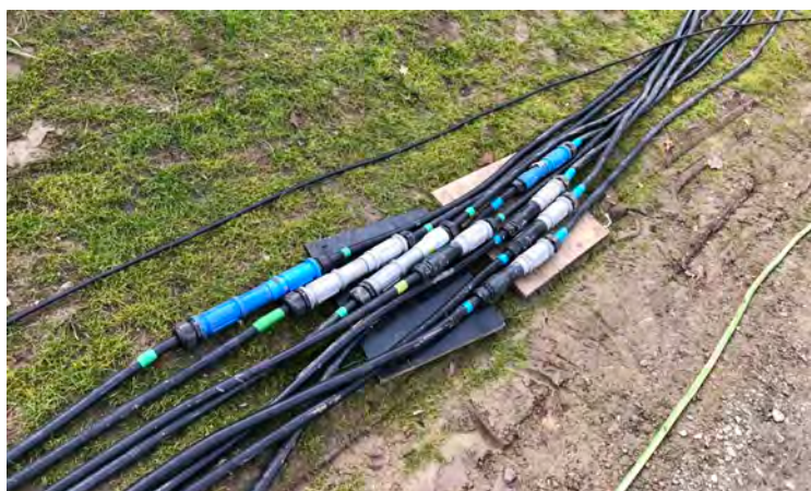
Cavi elettrici e connessioni provenienti da bi-gruppo elettrogeno
