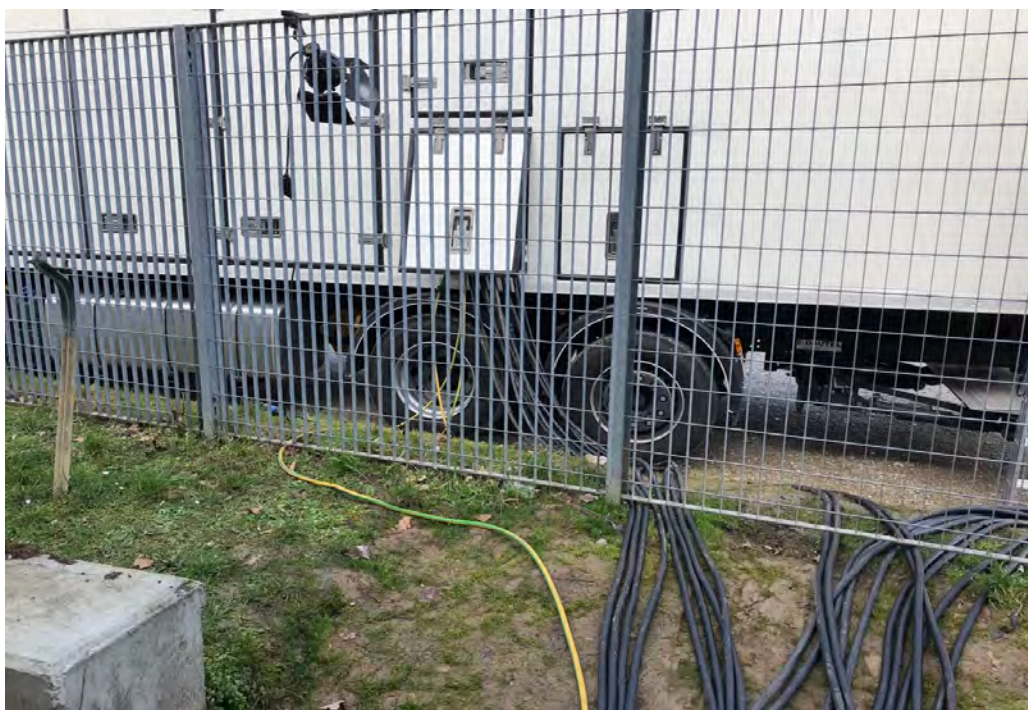
Cavi in uscita dal gruppo elettrogeno
