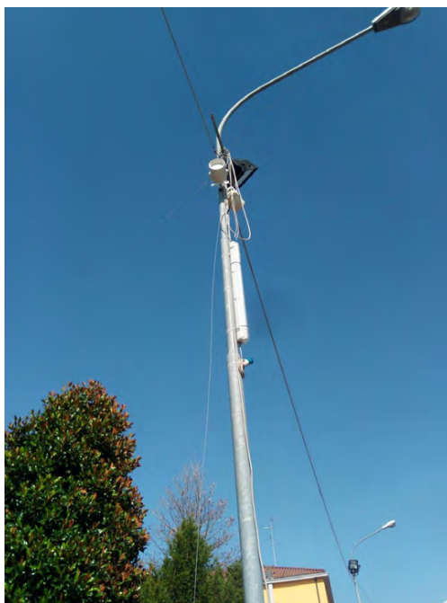
Strutture di illuminazione di sicurezza e impianto diffusore allarme vocale
