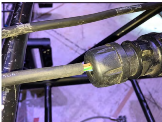
Spina con cavo non correttamente fissato al regolare fermacavo
