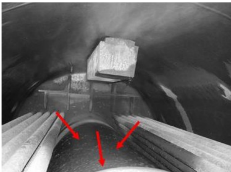
Molteplici corrosioni sul dorso focolare
