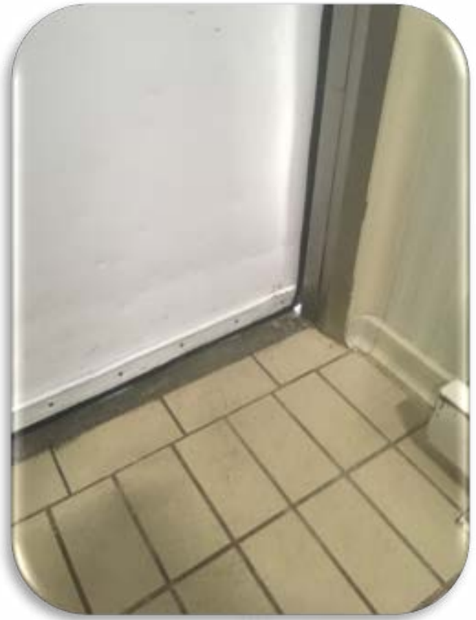
LA PORTA CHE DA SULL'ESTERNO È DANNEGGIATA
