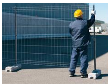
Figura 2 - elementi mobili con basamento in cls
