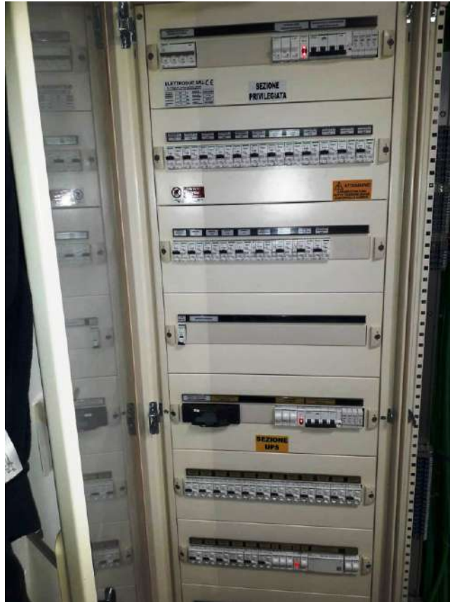
Figura 1 - Quadro alimentazione locali "Q.LAB"
