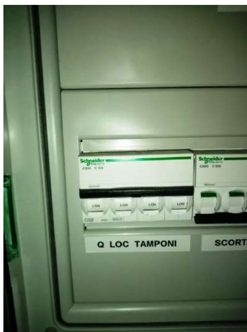
Figura 3 - QE HMN 1°P CONT. UPS interruttore MT 4XC32A denominato "Q LOC TAMPONI"
