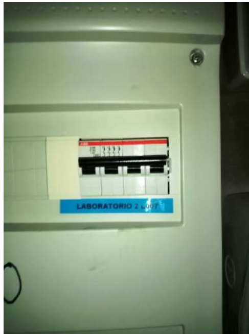
Figura 2 - 1. QE HMN 1°P PRIV.interruttore MT 4XC25A denominato "LABORATORIO 2 L007"
