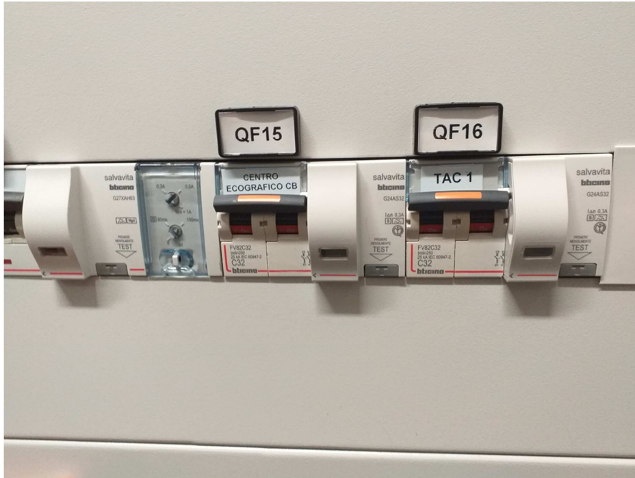
Fig. 4 . Interruttore e monte denominato “QF16-TAC1” nel quadro “B-Q01(UPS)” (locale L025)
