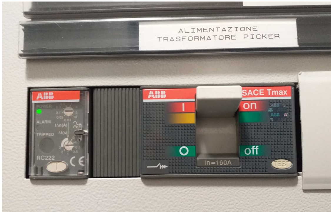
Fig. 3 Interruttore In 160 A alimentazione Picker in quadro BB-Q08 del locale L054
