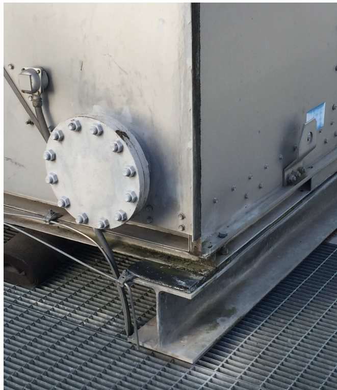
Profili di ripartizione del carico del gruppo frigo e supporto antivibrante tra gruppo frigo e profili di ripartizione
