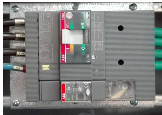
Interruttore su Q. PT alimentante Q.TC
