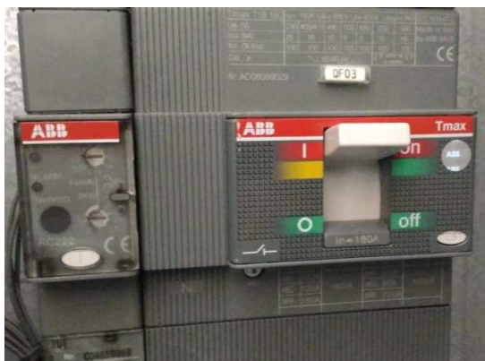
Interruttore Alimentazione TC su (Q.TC)
