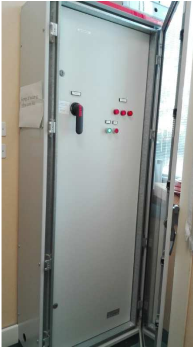
Quadro Alimentazione TC esistente (Q.TC)
