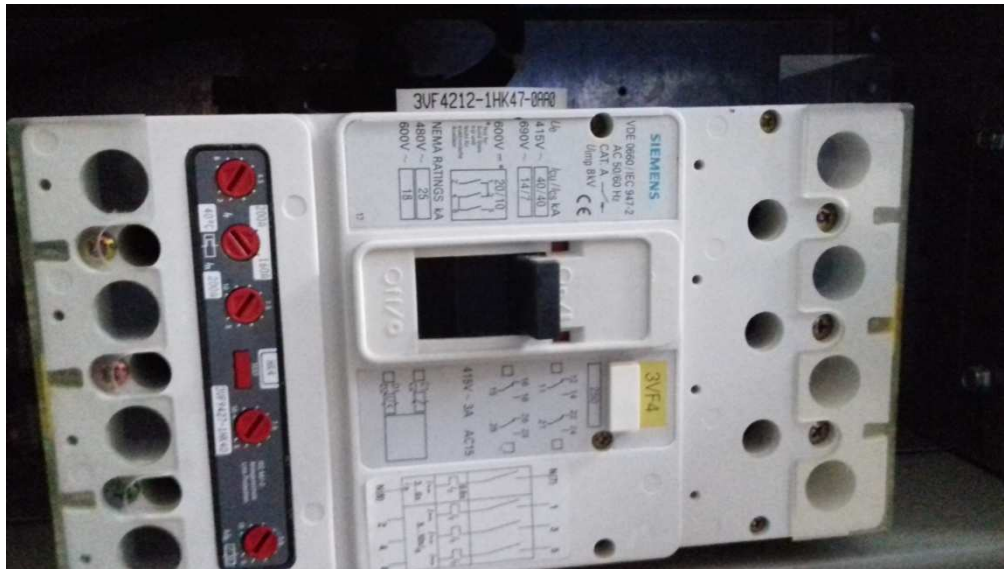
Interruttore su quadro di piano che alimenta QE.TAC2
