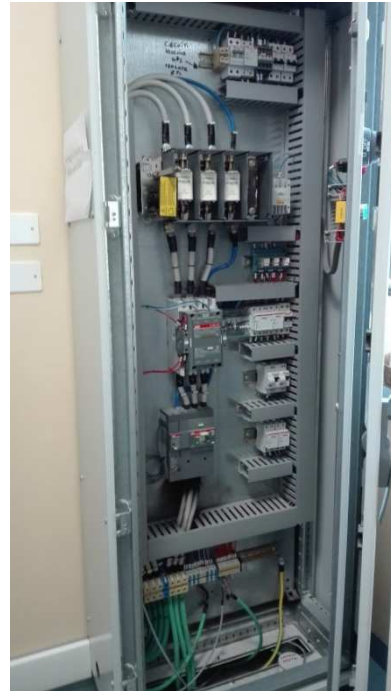
Quadro Alimentazione TC esistente (Q.TC)
